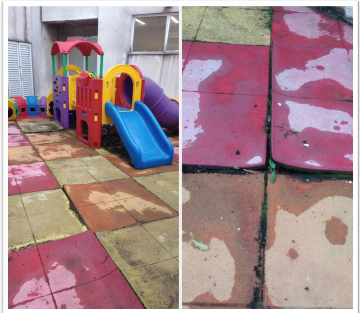
Foto 37 e 38 – O “parquinho” do prédio novo encontra-se interditado, pois o piso emborrachado precisa ser substituído.
