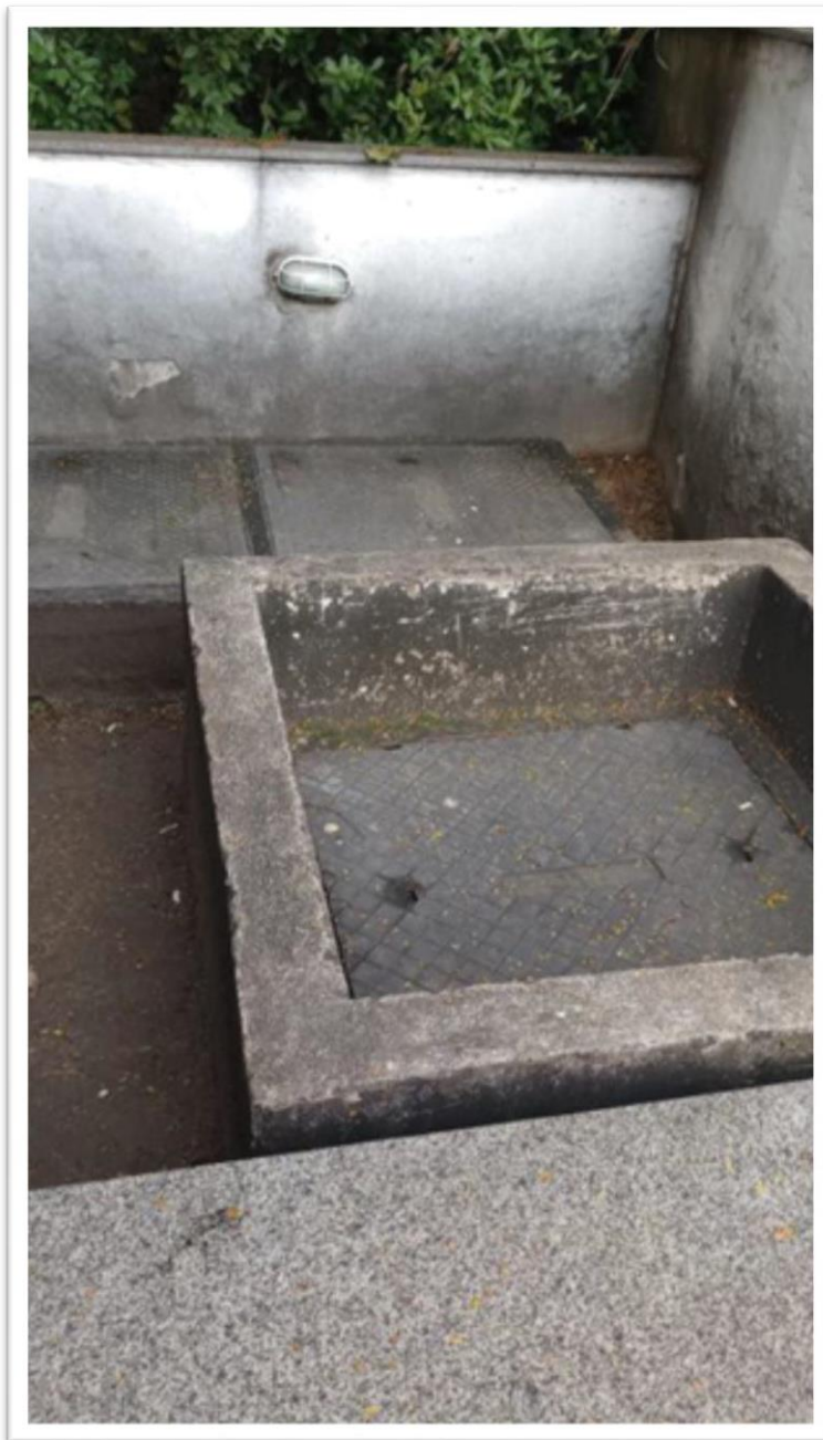
Foto 03 – Casa de bombas de incêndio semienterrada, não possui ralo interno, em casos de chuvas a água não pode ser escoada. As bombas precisam de manutenção e adequação para regularizar o funcionamento.
