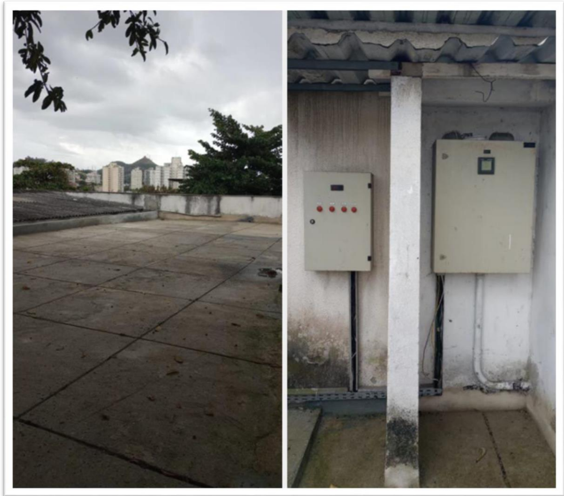
Foto 26 e 27 – Instalação de painéis de energia solar para fornecimento de energia para o sistema do boiler e outros pontos elétricos de maior demanda. Hoje não há nenhuma placa devido a furtos constantes, quadros da energia solar estão desativados. Prever reinstalação e sistema de segurança.
