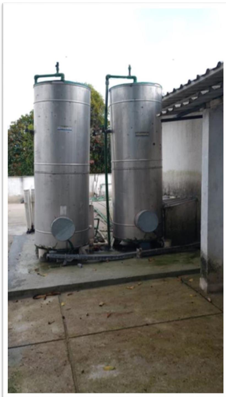
Foto 25 – Avaliação e adequação do sistema do boiler. Apenas um encontra-se em funcionamento.
