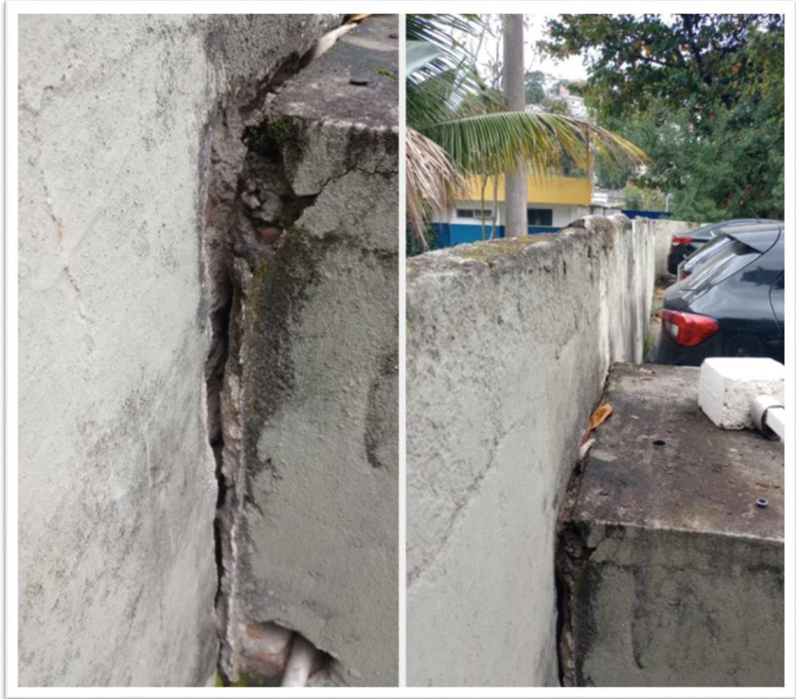
Foto 30 e 31 – Execução muro de contenção na área do estacionamento, com alto risco de desabamento.
